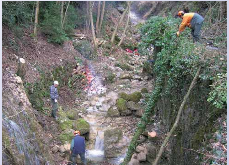
Les services techniques de la commune entretiennent régulièrement les abords des ruisseaux afin d'éviter les embâcles.
